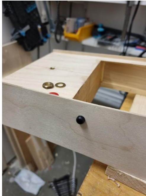
Foto 63: Der Wasserauslauf für das Kühlwasser. Dieses muss über der späteren Wasserlinie liegen
